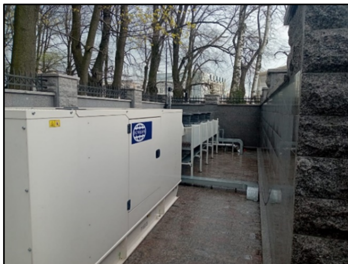
Рисунок 4 – Драйкулер и ДГУ в приемке на территории жилого сектора с многоэтажной застройкой
