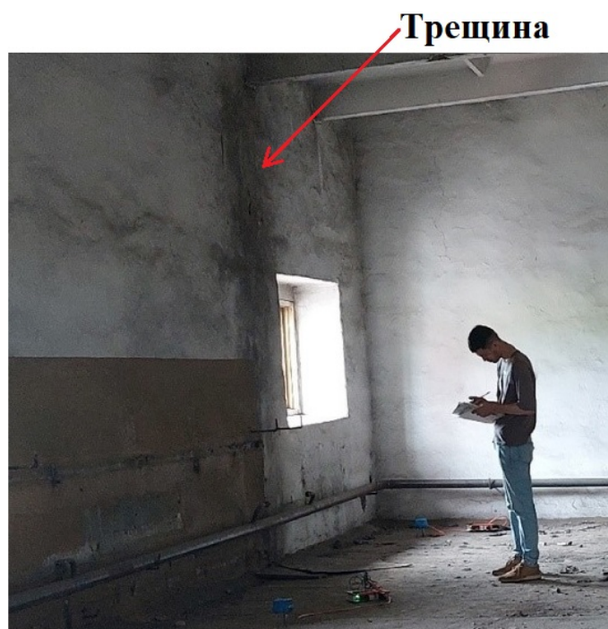
Рис. 9. Трещина на втором этаже здания
